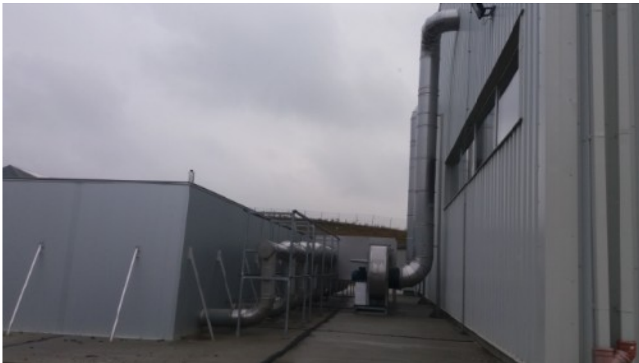
Biofiltru aferent instalatiei TMB
