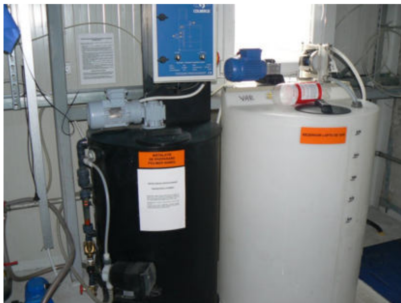
Figura nr. 13: instalație de spălare gaze
