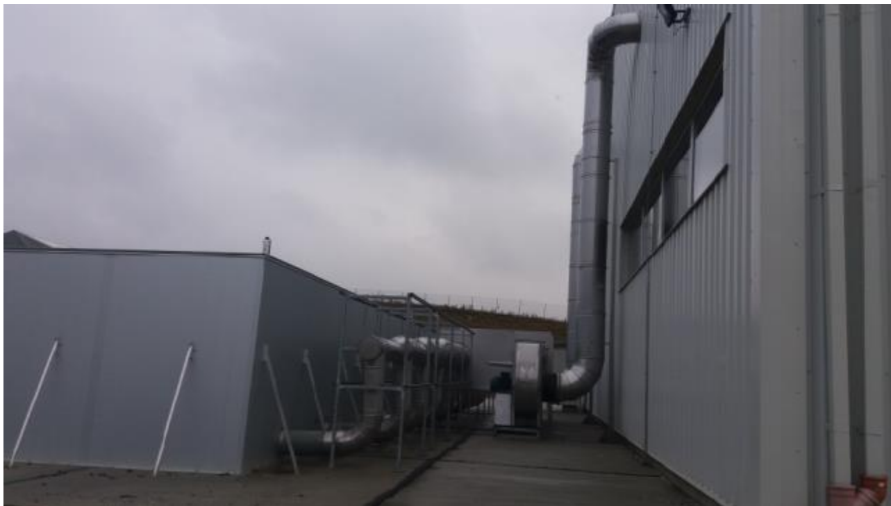
Biofiltru aferent instalatiei TMB
